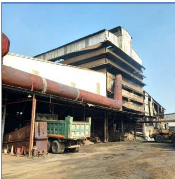
Hệ thống đường ống dẫn khí
