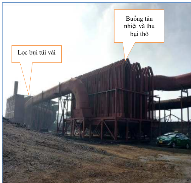
Hệ thống lọc bụi
